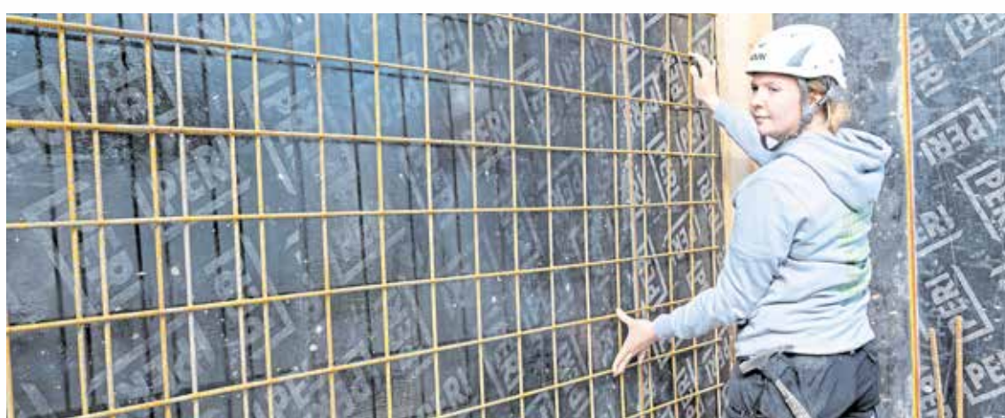
Als Maurerin muss Mareike nicht nur belastbar sein und ein gutes Auge beweisen. Hin und wieder ist auf der Baustelle auch Fingerspitzengefühl gefragt.
