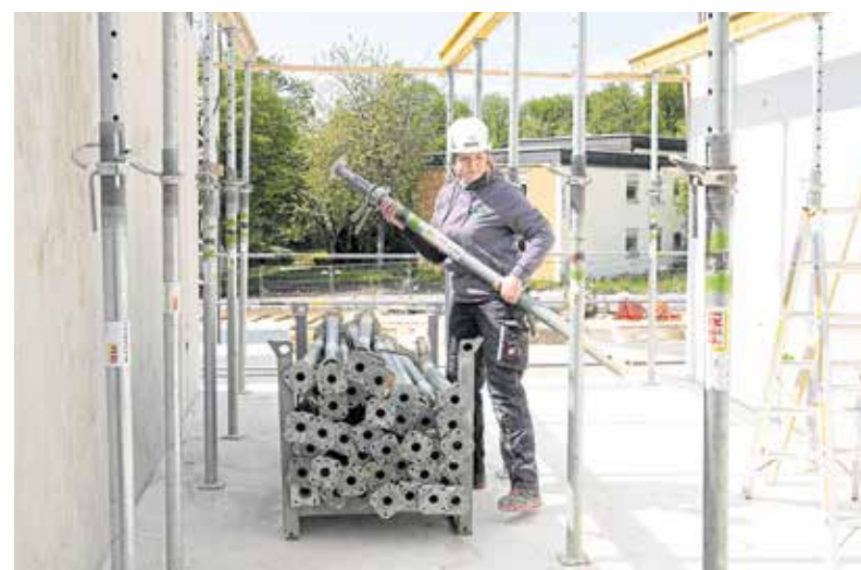
Auch als Frau kann man zupacken. Das beweist Mareike auf der Baustelle jeden Tag. Fotos: Handwerkskammer Ulm
