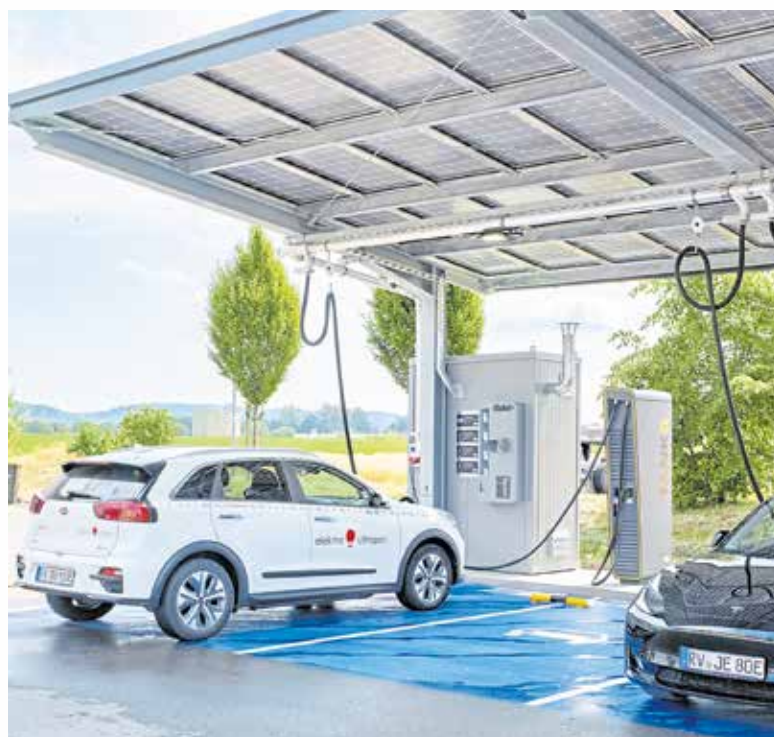
Unter Strom: Die neue E-Tankstelle verfügt über fünf hochmoderne Schnellladepunkte.
