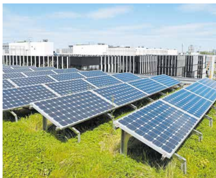
Gründach-PV verbessert das Mikroklima und bringt die Energiewende nach vorne. Foto: Bundesverband Gebäude-Grün
